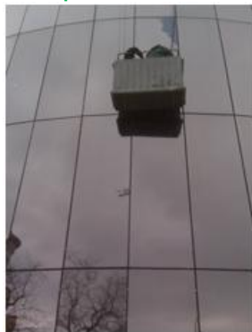
Colocación de sensor externo de superficie en Nexus I
